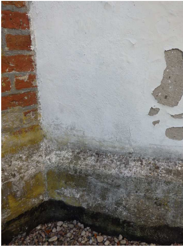
Kościół pw.. Matki Bożej Różańcowej w Koszalinie, betonowy cokół i powłokowa izolacja pionowa
