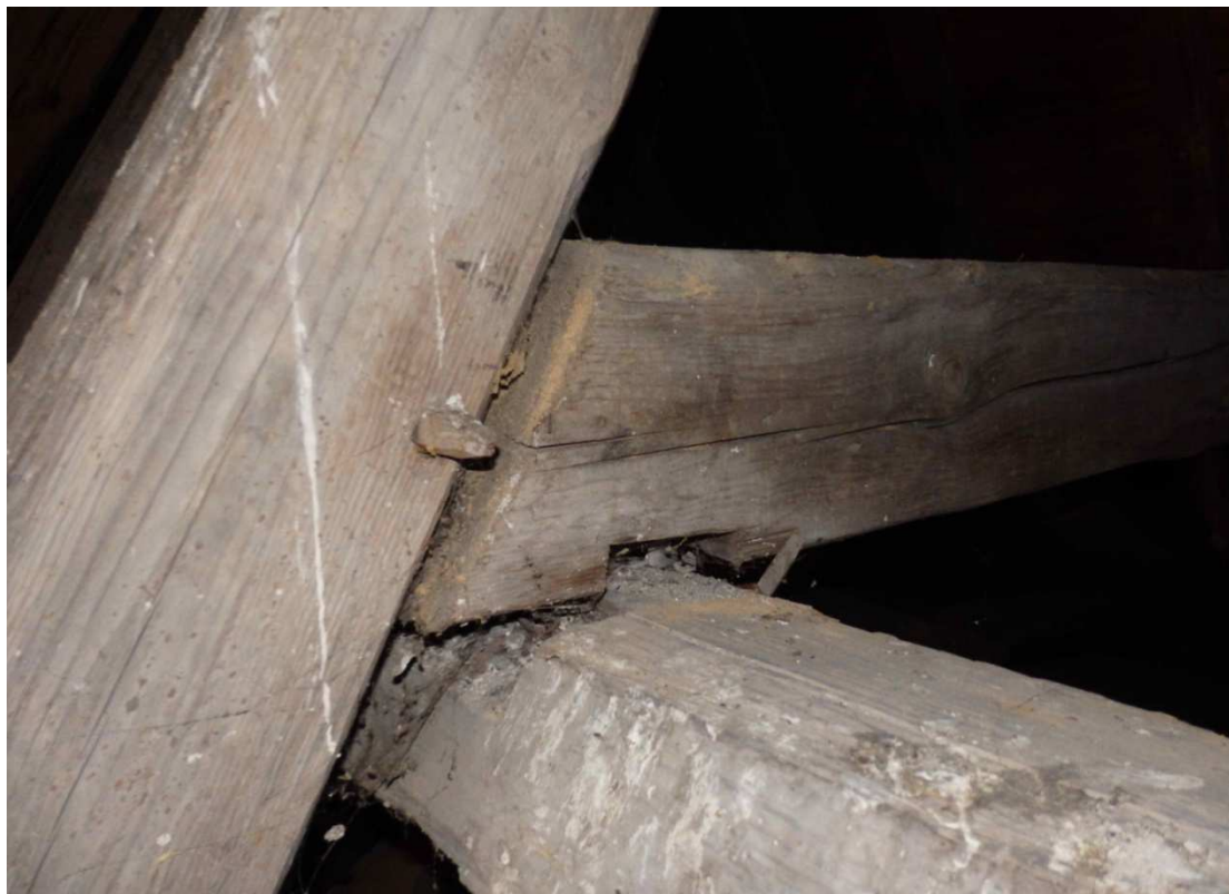
Kościół pw.. Matki Bożej Różańcowej w Koszalinie, więźba dachowa nad nawą, zerwane i rozluźnione węzły ciesielskie
