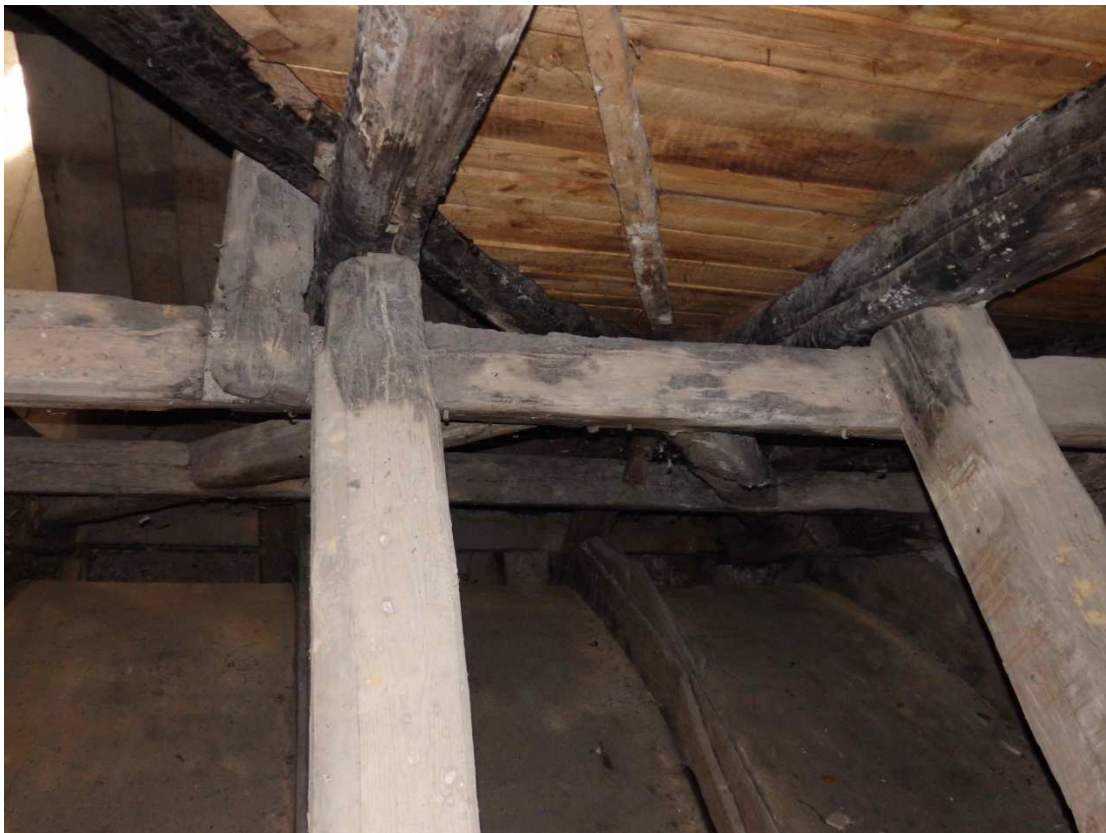
Kościół pw.. Matki Bożej Różańcowej w Koszalinie, sklepienie kolebkowe od strony poddasza, widoczne ślady po ostatnim pożarze i ślady żerowania drewnojadów
